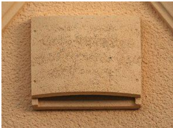
Foto oben: Fassadenflachkasten
