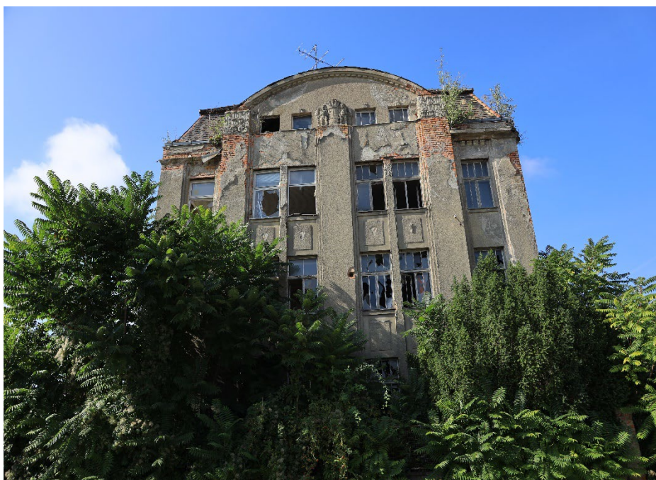
Abbildung 15: Blick auf die alte Emallierfabrik von der Freiligrathstraße mit noch reichem Umgebungsgrün (23.08.2022).
