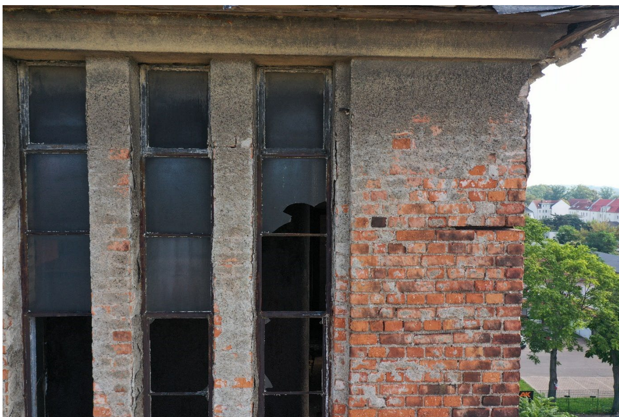
Abbildung 24: Durch solche Glasfenster im Turm können Zuflugsmöglichkeiten zu dahinter angebrachten Nistkästen für Turmfalke oder Dohle geschaffen werden. In den umlaufenden Sims darüber können Nistbausteine für Vögel oder Quartiersteine für Fledermäuse denkmalschutzgerecht eingebaut werden.
